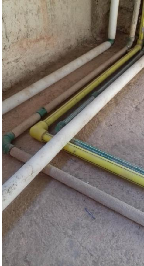
Figura 31: falta de sobrepasos
