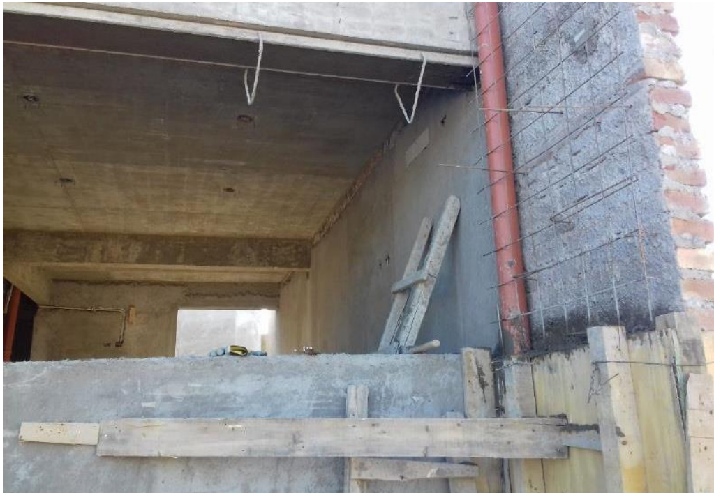
Figura 25: desagüe no previsto
