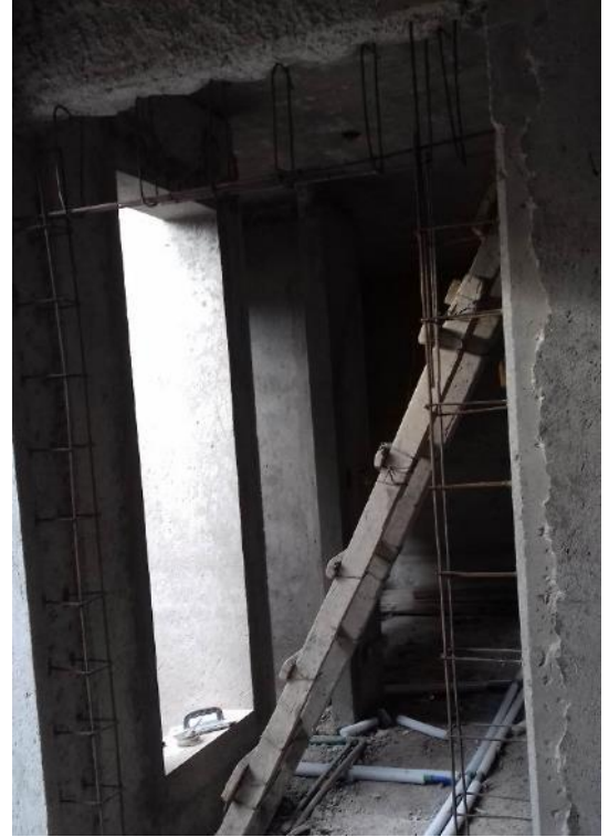
Figura 22: columnas y viga dintel faltantes
