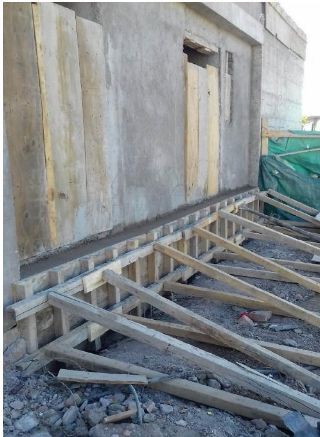
Figura 27: muro no previsto en plano de fachada
