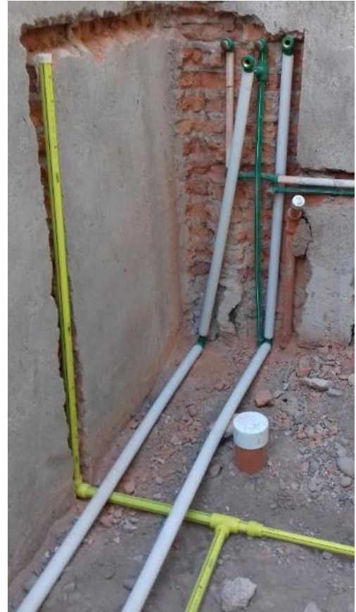
Figura 32: falta de sobrepasos
