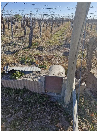
Figura 32: Infraestructura utilizada para riego por manto en AE bajo manejo convencional.
